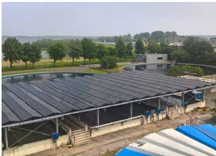
Zonnepanelen op rioolwaterzuivering
